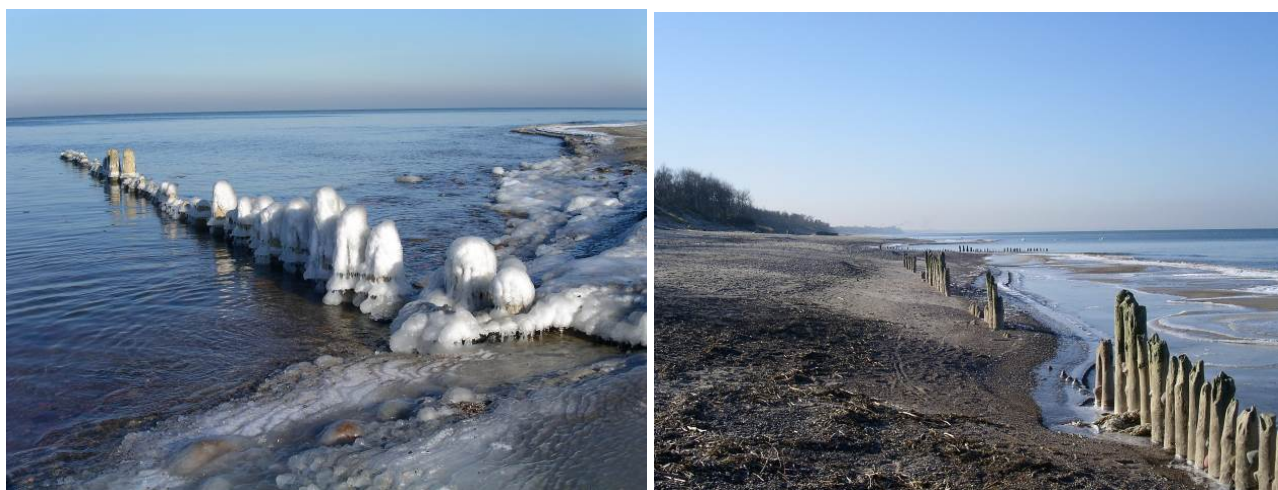
Рисунок 18. Продольные и поперечные однорядные немецкие буны при низком уровне воды в корне косы
